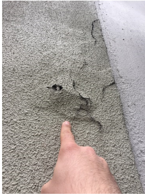
Kabaran gevşek kısımlar
